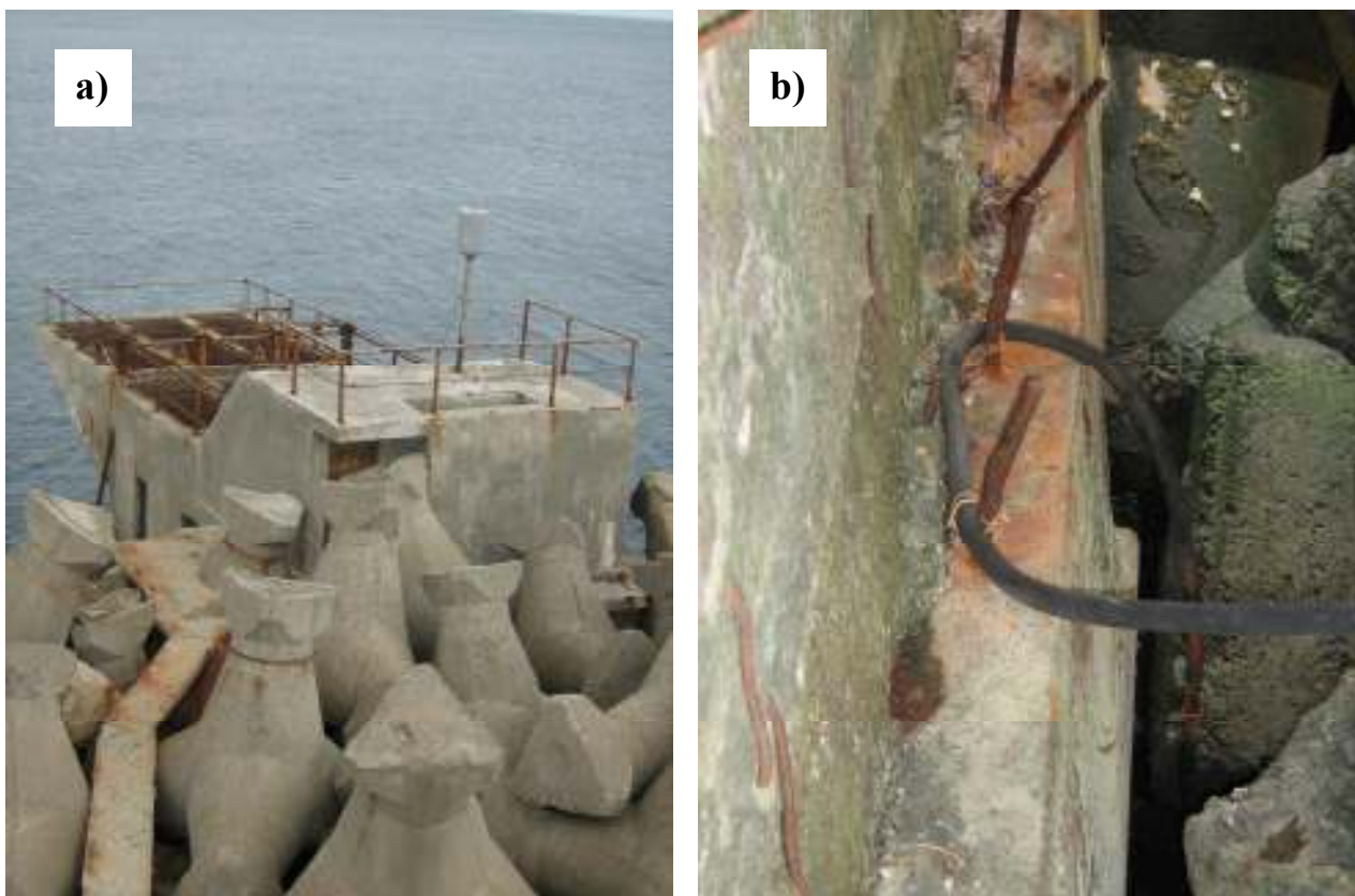
Fig. 2 Stația de măsurare a înălțimii valurilor de la Mangalia: a) platforma stației; b) amplasarea senzorului ce măsoară valurile. Foto I. Jurchă, 2008.
